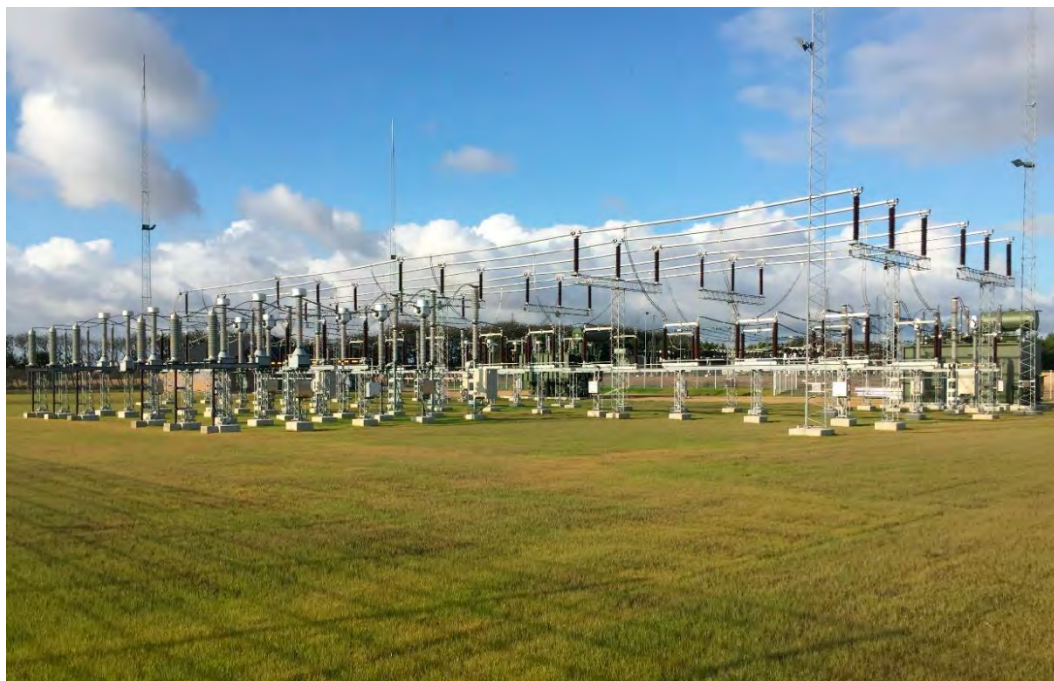
Figur 8-56 Højspændingsstation med 11 m høje tekniske anlæg, op til 24 m høje lynafledere samt mindre bygninger og andre anlæg.
