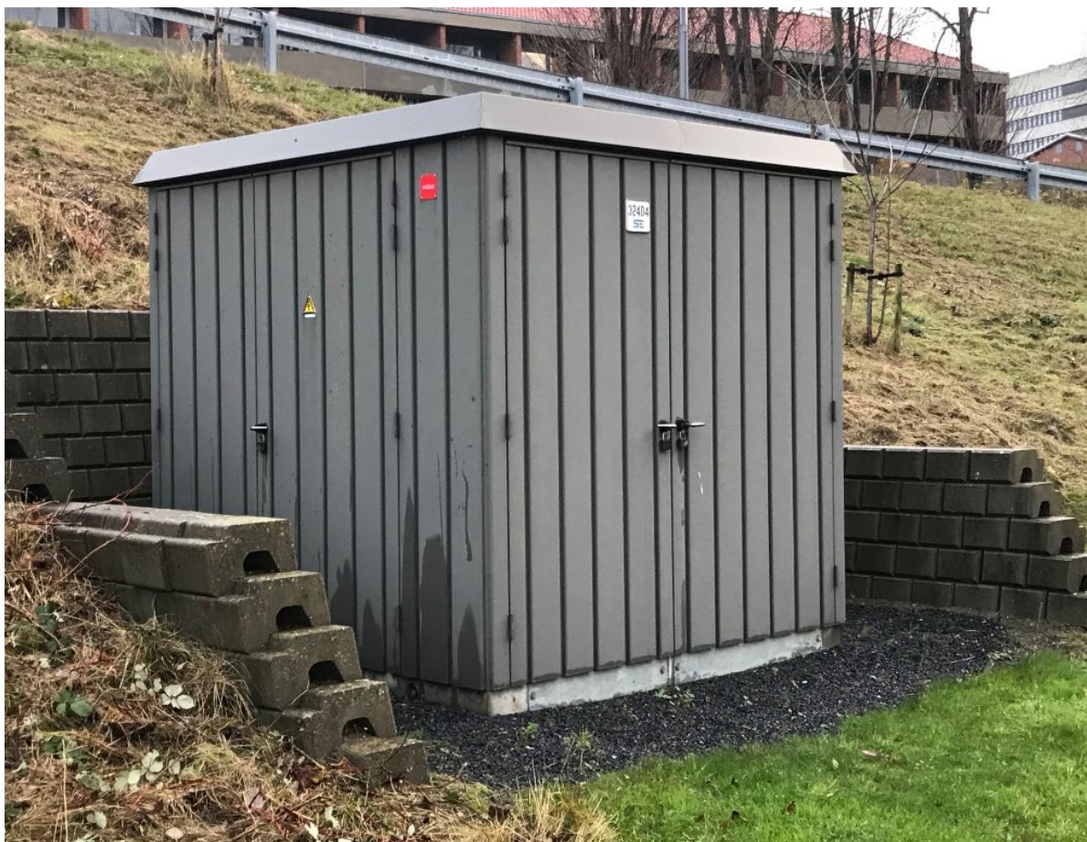
Figur 2-16. Eksempel på transformerstation.
