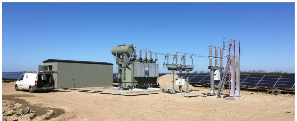
Figur 1-6 Eksempel på stepup-transformer og teknikbygning.
