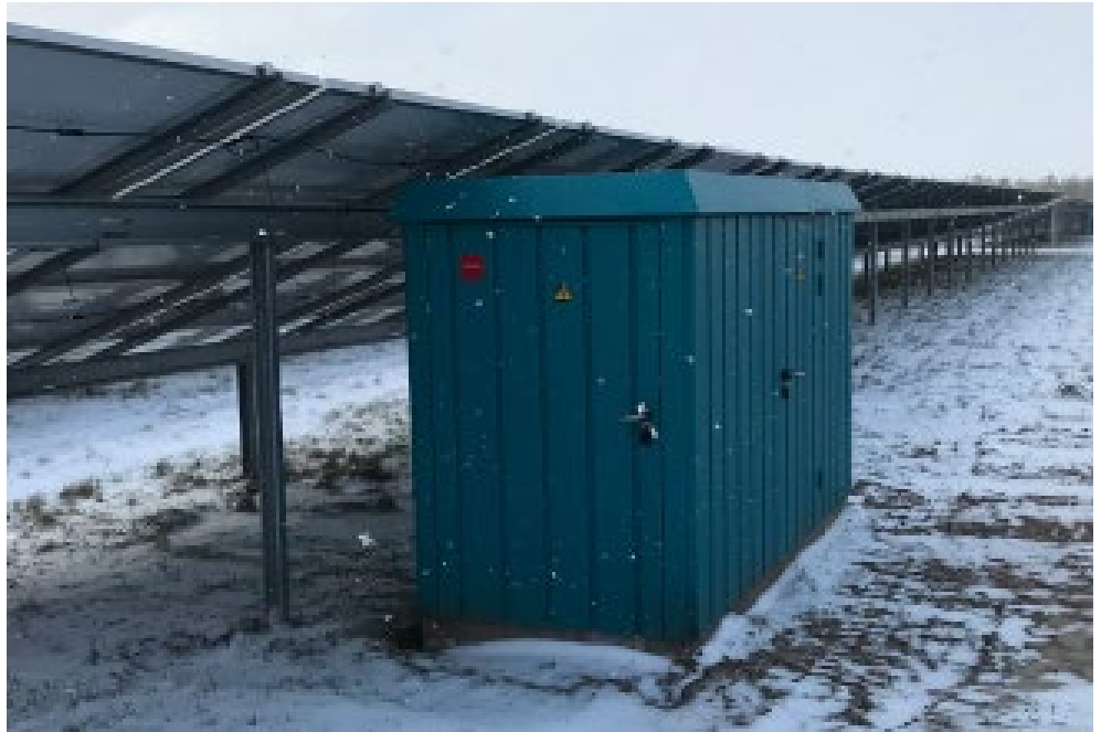
Figur 1-5 Eksempel på transformer.
