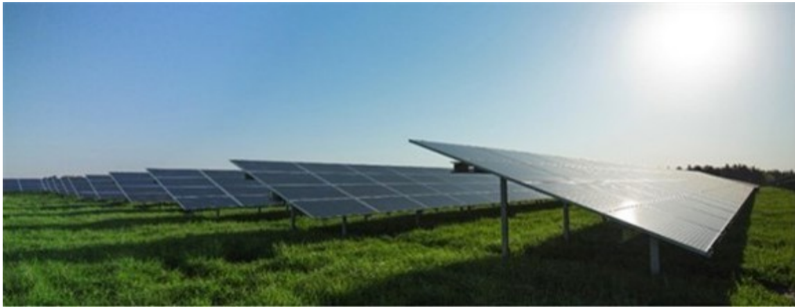
Solcellepaneler på terræn.
