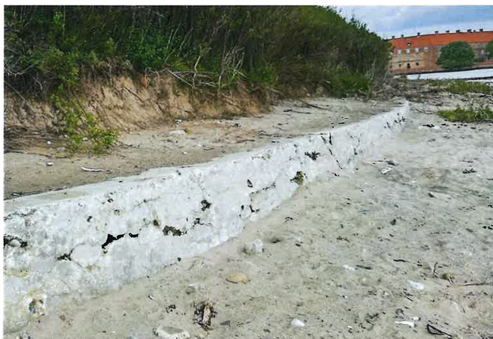
Figur 2-2 Foto af den gamle betonstøttemur foran ejendommen, Sundgade 64, set mod nordøst i maj 2024.
