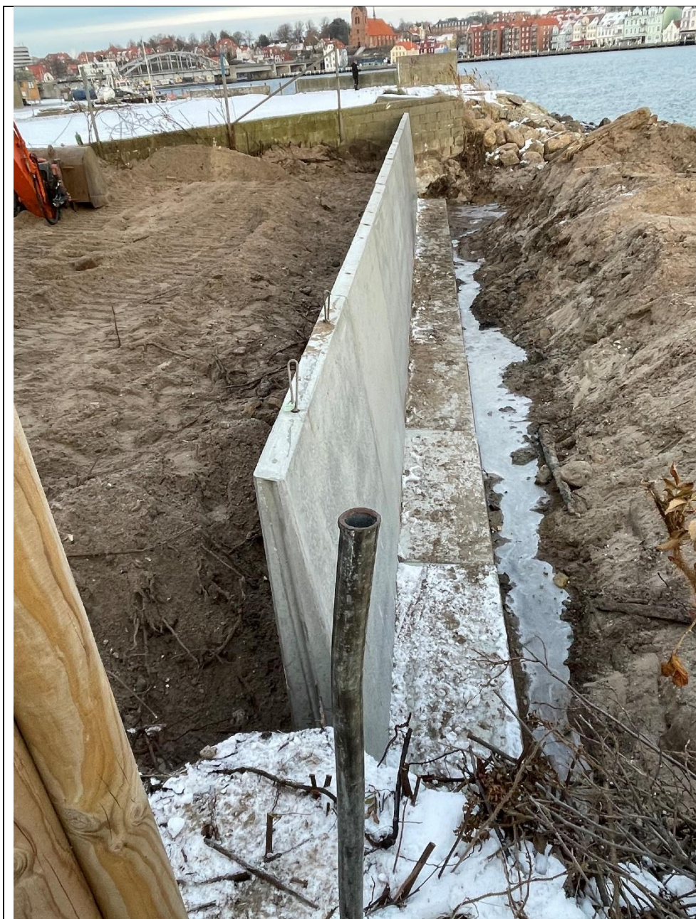
Figur 5: De ønskede L-elementer i beton ses her på nabostrækningen. Se detaljer om L-profiler i Bilag 4.
