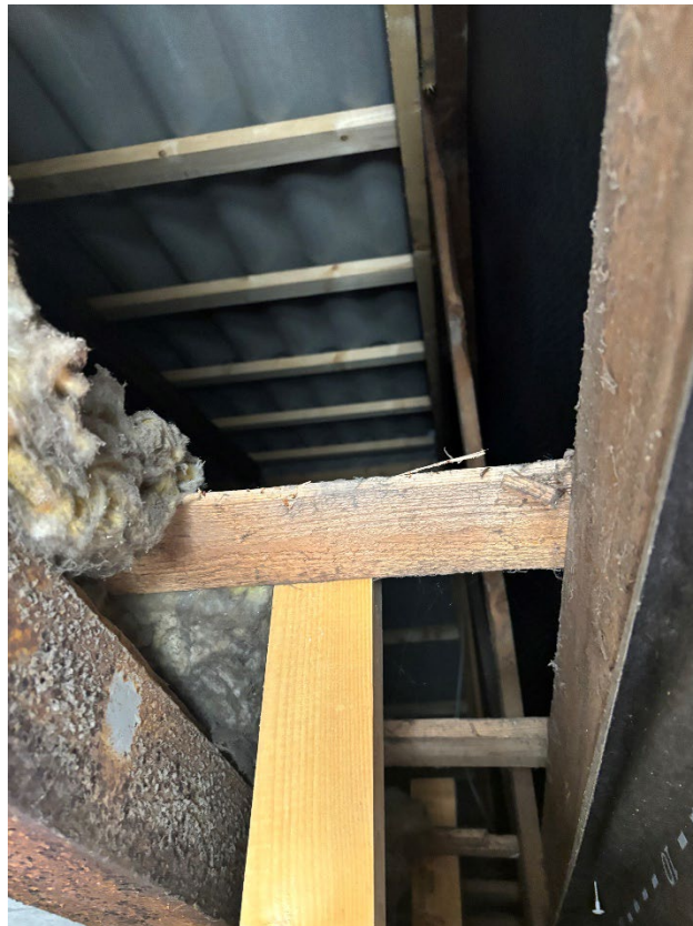
Figur 4: Nærbillede af tagkonstruktionen viser, at loftsrummet ikke er tilstrækkeligt isoleret til at flagermus kan trives.
