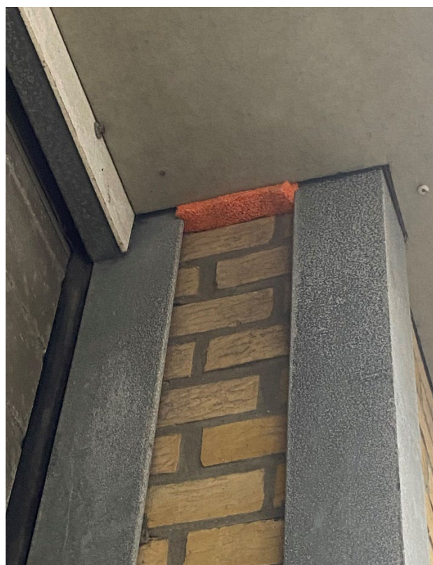
Figur 6: For at modvirke potentiel adgang indtil planlagt nedrivning, har ejer d. 11. juni 2026 lukket sprækken.
