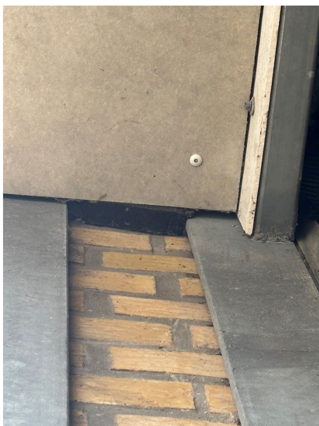
Figur 3: Åbning til tagrummet, som udgør en potentiel adgang for flagermus.
