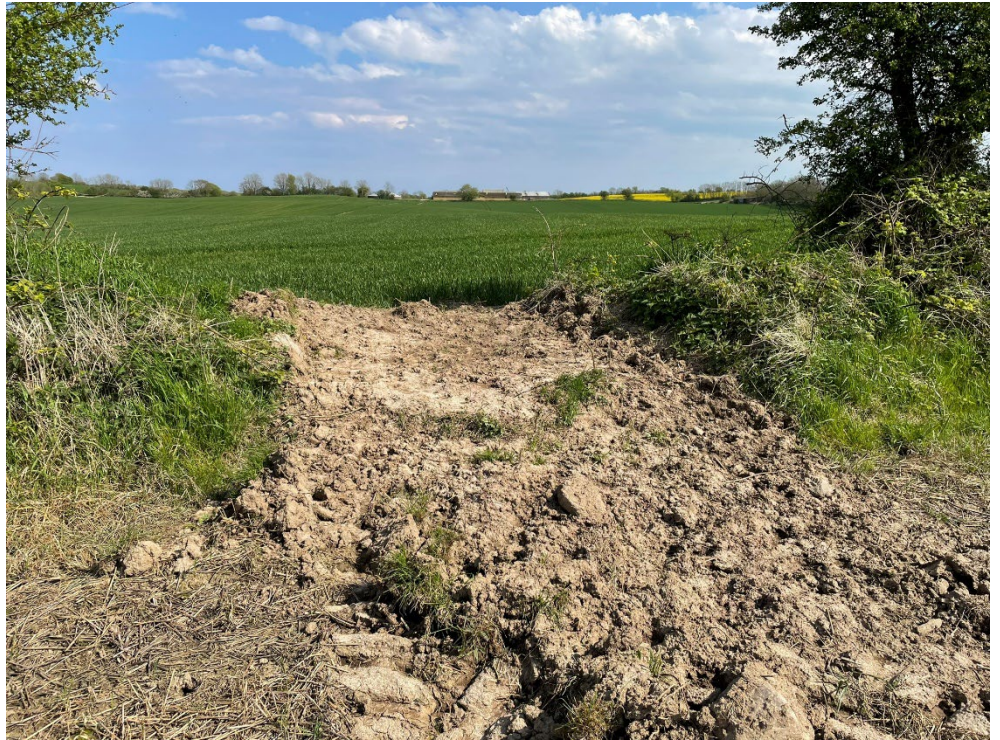
Figur 3-70 Digebrud på N16D. Foto er taget i retning mod øst.
