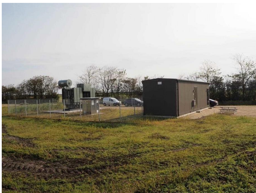
Referencefoto af en tilsvarende transformestation fra ansøgningen.
