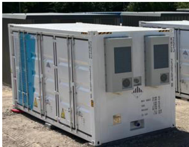
Figur 1-9 Eksempel på energiopbevaring med batteri i containerløsning.
