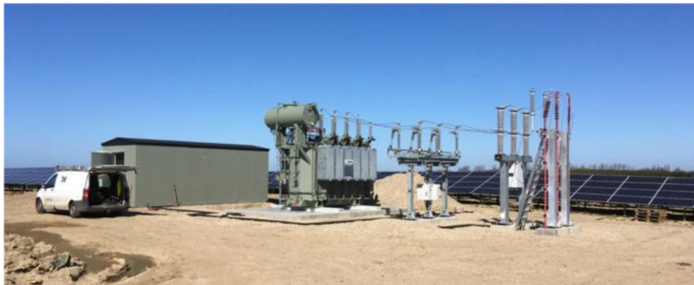
Figur 1-8 Eksempel på step-up-transformer og teknikbygning.
