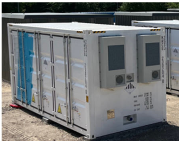
Figur 1-9 Eksempel på energiopbevaring med batteri i containerløsning.
