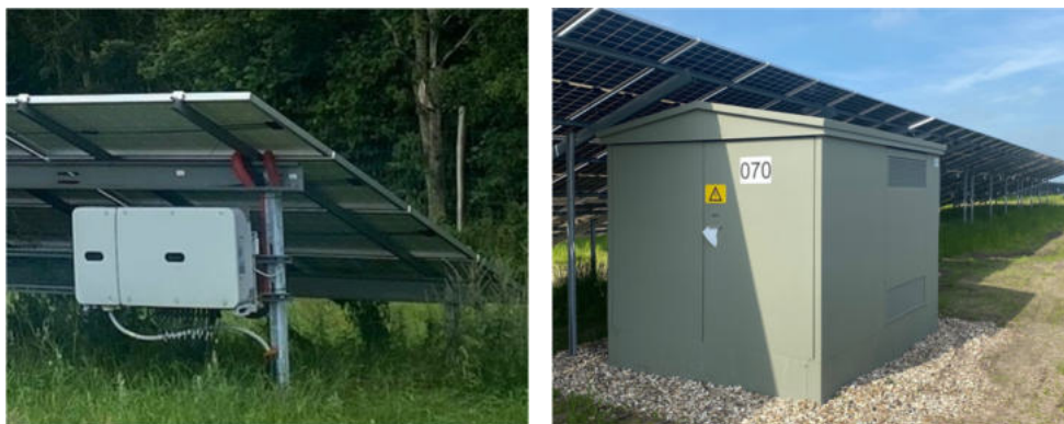
Figur 1-5 Eksempel på inverter (t.v.) og transformer (t.h.).
