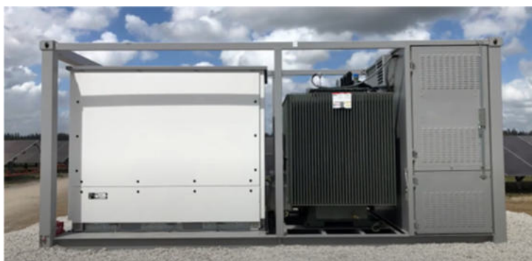
Figur 1-6 Eksempel på centralinverter.
