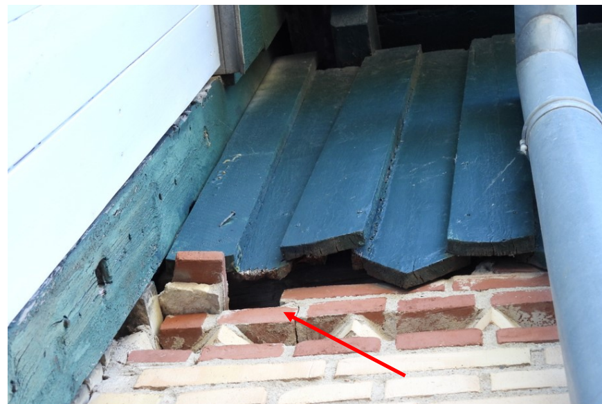
Sidebygning vest mod hovedbygning på vestside, huller og spalter
