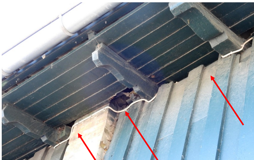
Hovedbygning – huller og spalte mellem sidevæg og tag- overgang.
