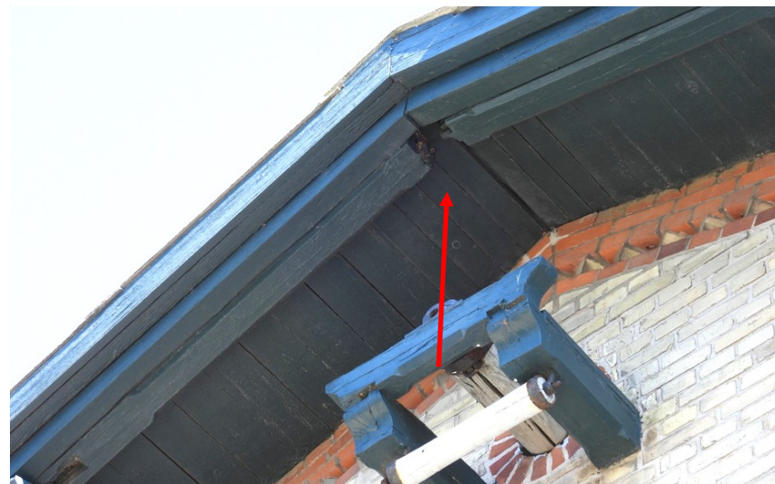
Sidebygning øst – syd gavls - spalter og huller
