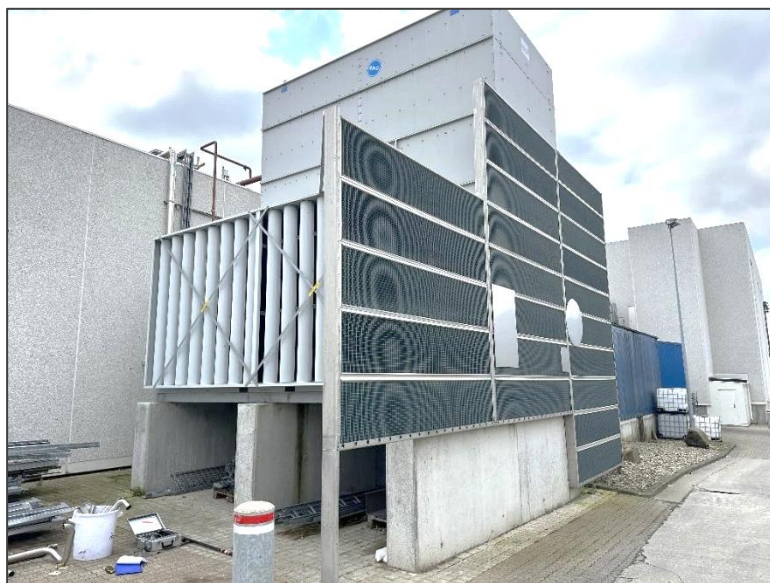
Figur 2 Kilde 60 - Køleanlæg Baltimore Aircoil, BAC 620 samt støjskærm på nordlig side. Målt 2024-09-19. Set fra nordøst.
