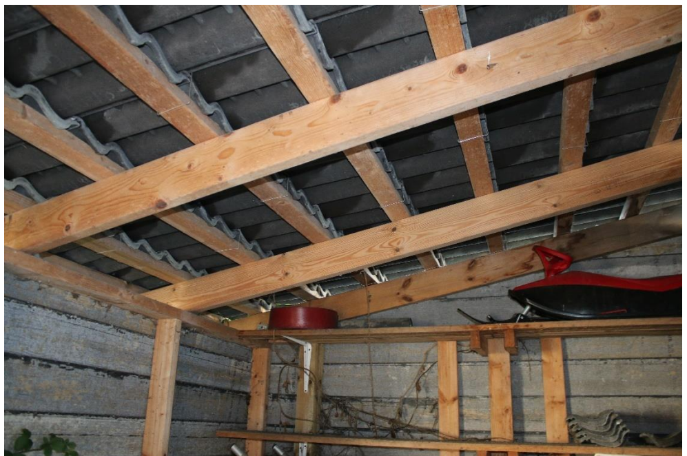
Figur 5-44 Skuret uden undertag eller isolering og uden flagermusegnede skjulesteder.
