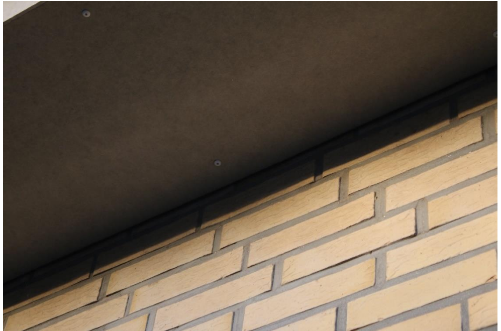
Figur 5-13 Tagudhæng og murværk slutter tæt og er uden mulighed for adgang til tagkonstruktion eller loftsrum.
