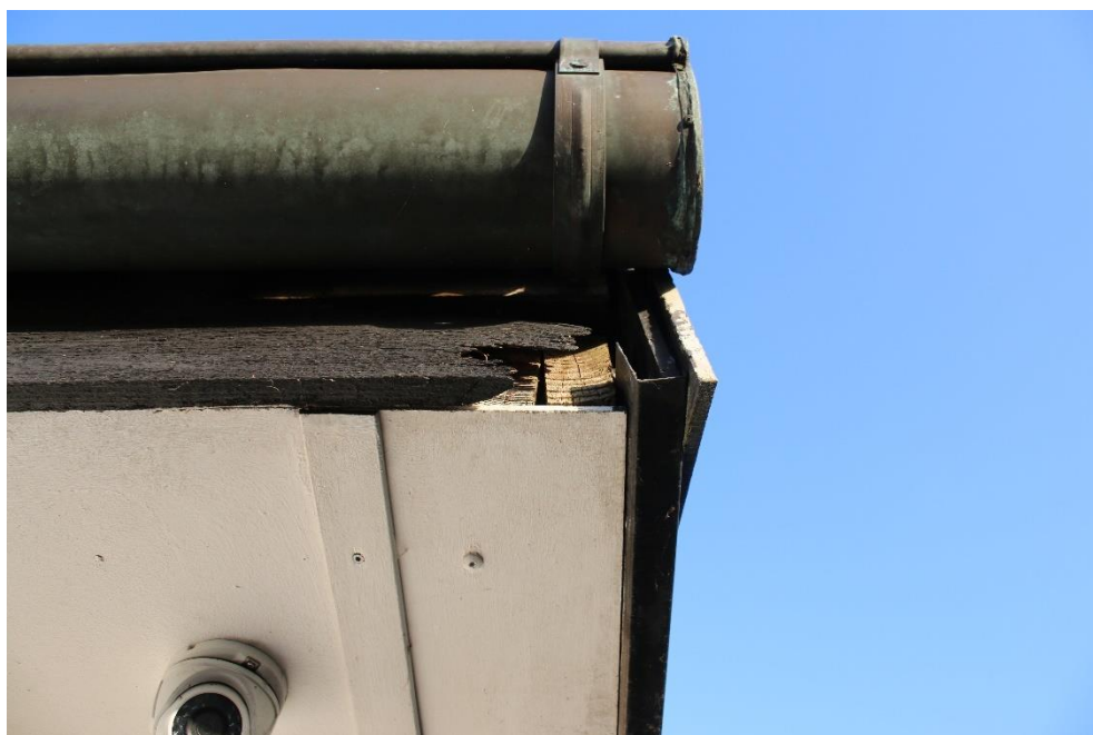
Figur 5-40 I hjørne ved gavl er tagudhæng delvis nedbrudt med hul, der giver adgang til tagkonstruktion og/eller loftsrum.
