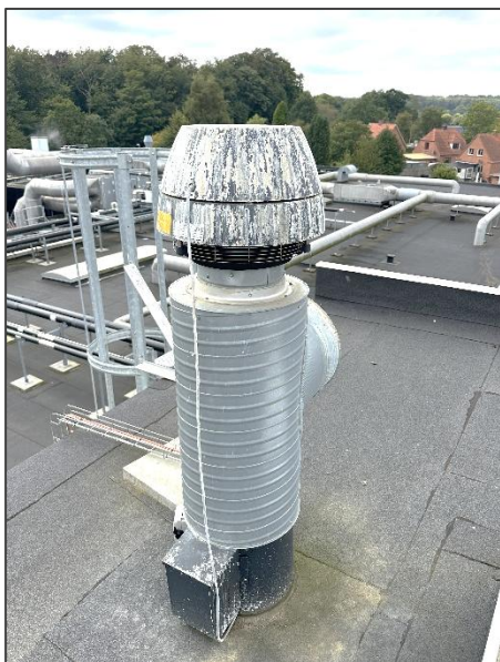
Figur 3 Kilde 34 (ny) - Tagventilator Exhausto 250 på taget af kondiment tankfarm set fra nordøst. Målt 2024-09-19.
