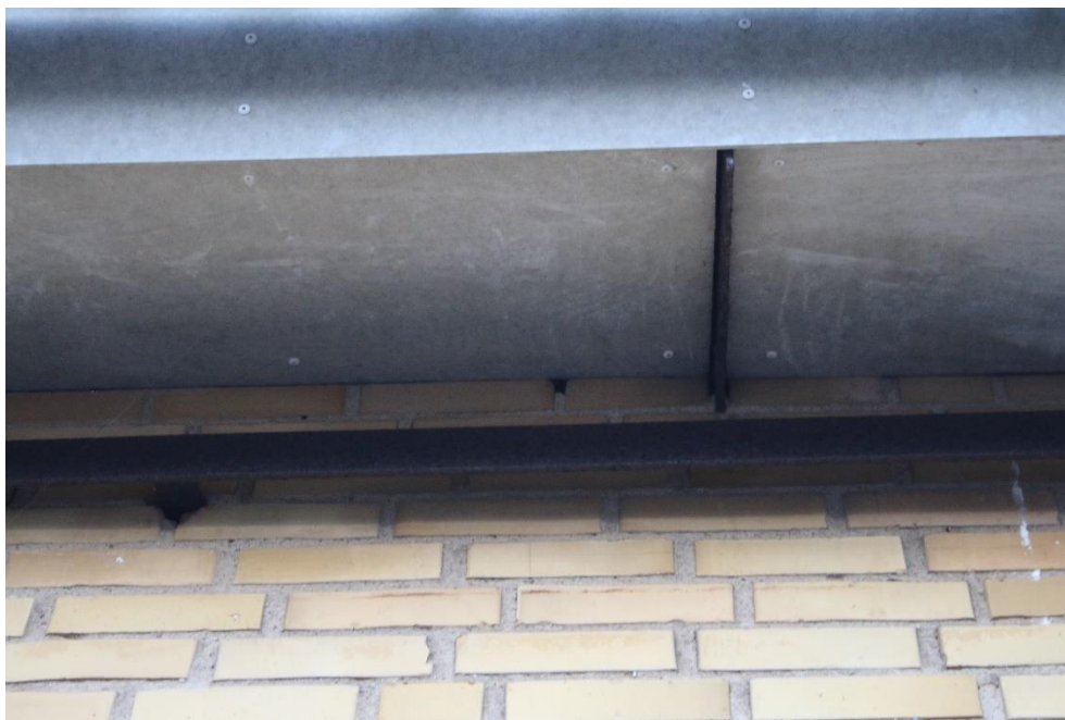
Figur 5-4 Langs siderne af bygningen enkelte (1 – 2) mindre huller i tilknytning til furer mellem mursten, men disse vurderes ikke dybe nok til at give adgang til tagkonstruktion.
