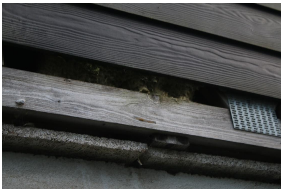
Figur 5-25 Bagtil giver manglende brædder fri adgang til tagkonstruktionen.
