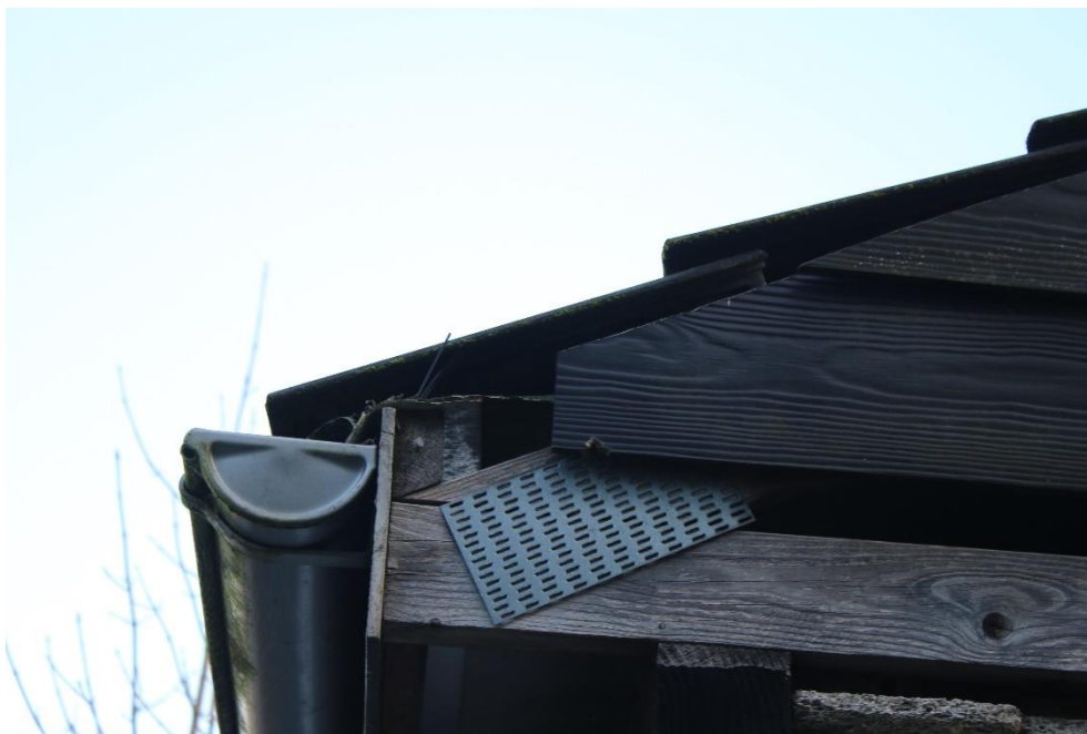
Figur 5-26 Huller og manglende brædder giver i gavlen fri adgang til tagkonstruktionen, og dermed ringe beskyttelse imod rovdyr.
