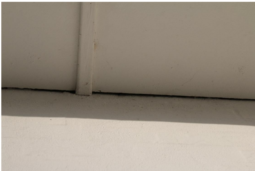
Figur 5-41 Ved østvendt mur er der en sprække mellem tagudhæng og murværk, der potentielt giver adgang for flagermus.
