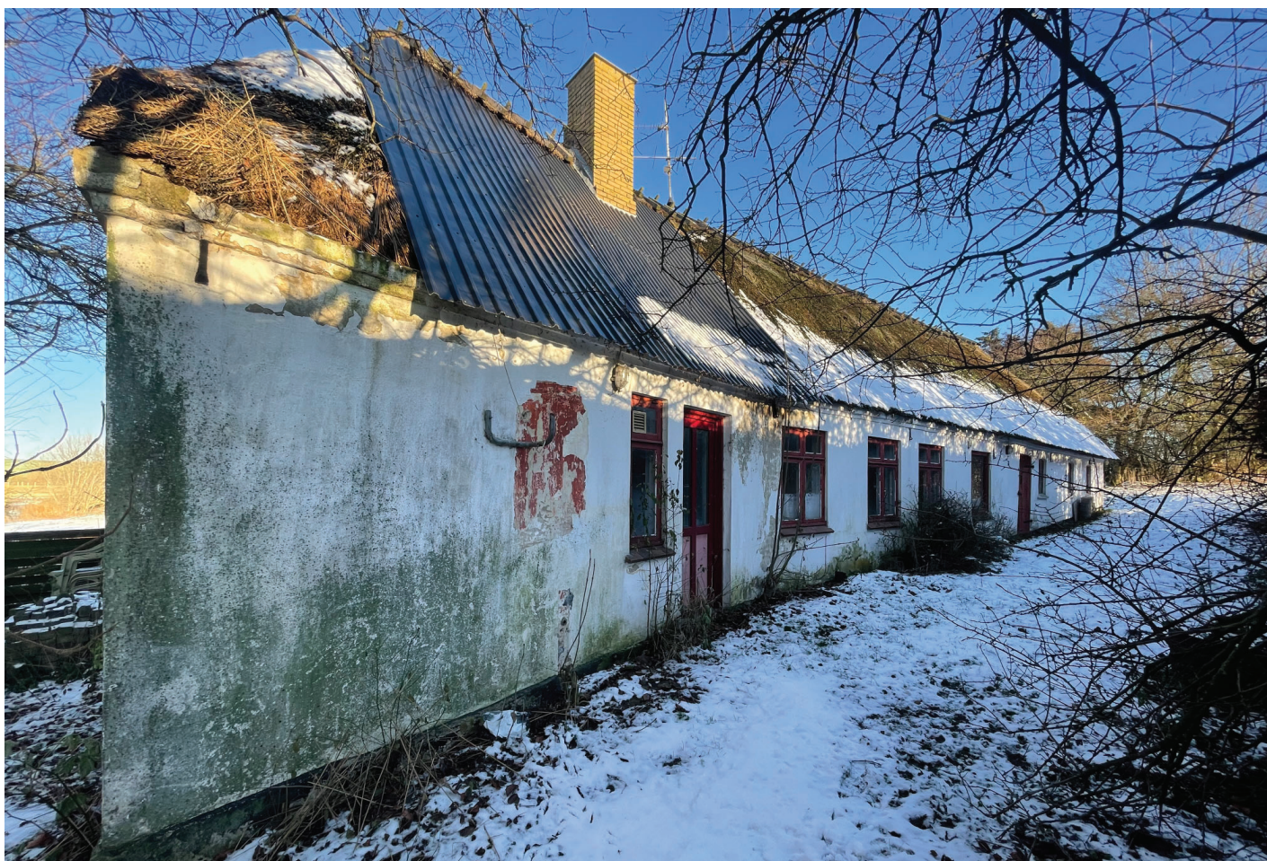
Sydfacaden set fra sydvest, hvor en del af taget er repareret med stålpladetag.
