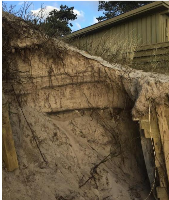
Figur 11. Foto af oprindelige anlæg, vestsiden. Billedet bekræfter at vandbevægelser har eroderet opfyldningen indefra. Den nybyggede afskærmning, forhindrer netop dette.
