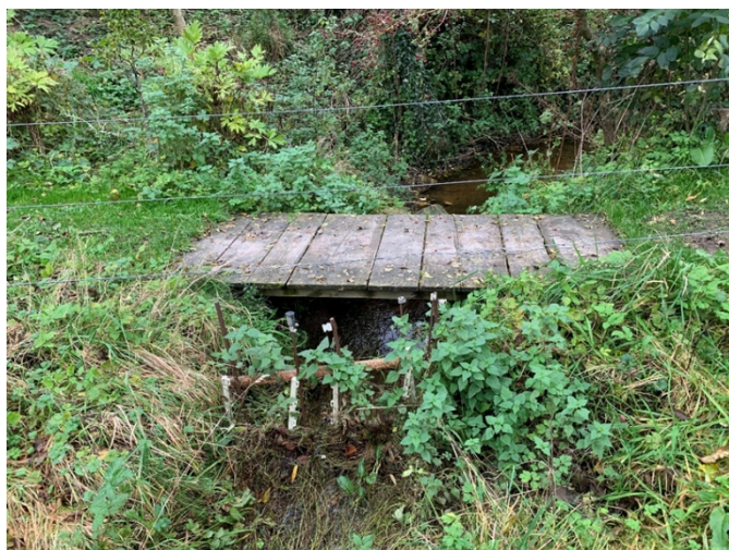
Gangbro der ønskes lovliggjort
