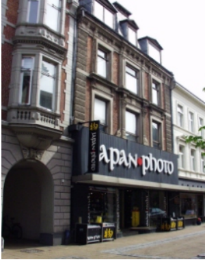
Husets flotte facade mangler noget at stå på.
