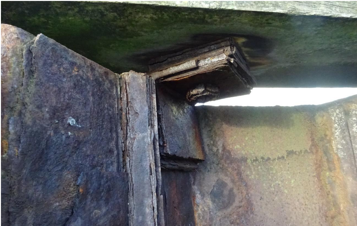
Figur 15: Korrosion af vinkelbeslag til fastgørelse af træhammer. Ælde
