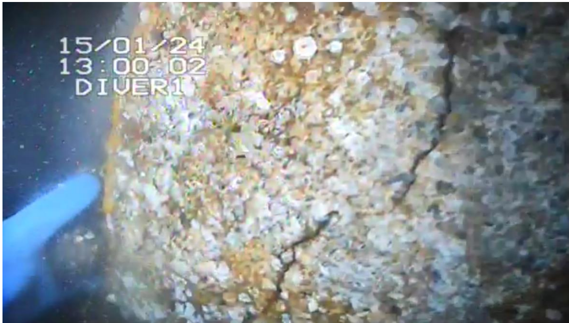
Figur 7: Revner ses mange steder i betonpæle Frost/tø
