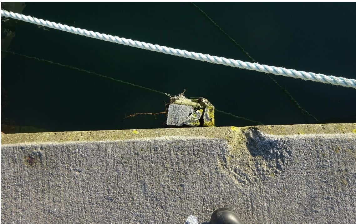
Figur 12: Flækket slidtømmer i toppen. Afskalning af betonoverflade nær vandlinje Råd, ælde, frost/tø
