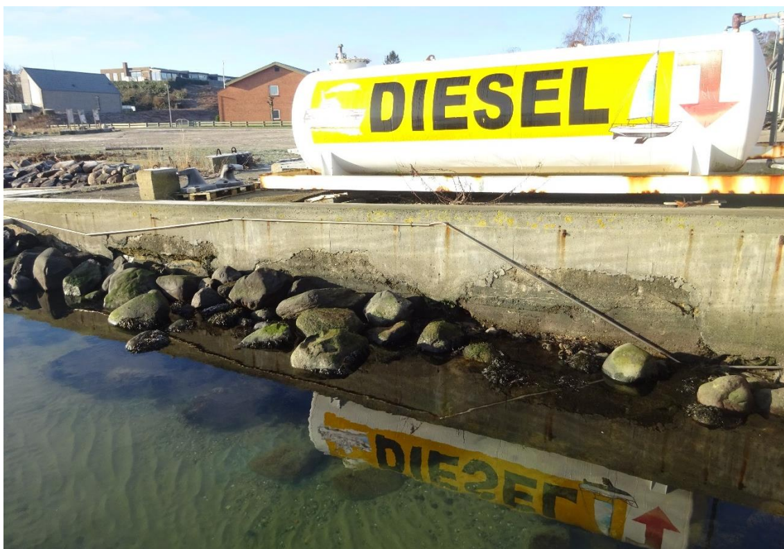
Figur 13: Afskalninger på betonstøttemur ved strækning 1. Manglende sten på stenskråning. Ælde, frost/tø
