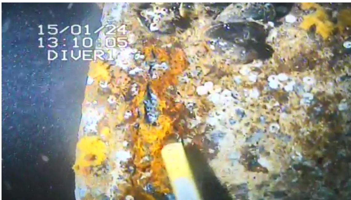
Figur 8: Nordlig pæl havde synlig rustudfældning i revne Frost/tø
