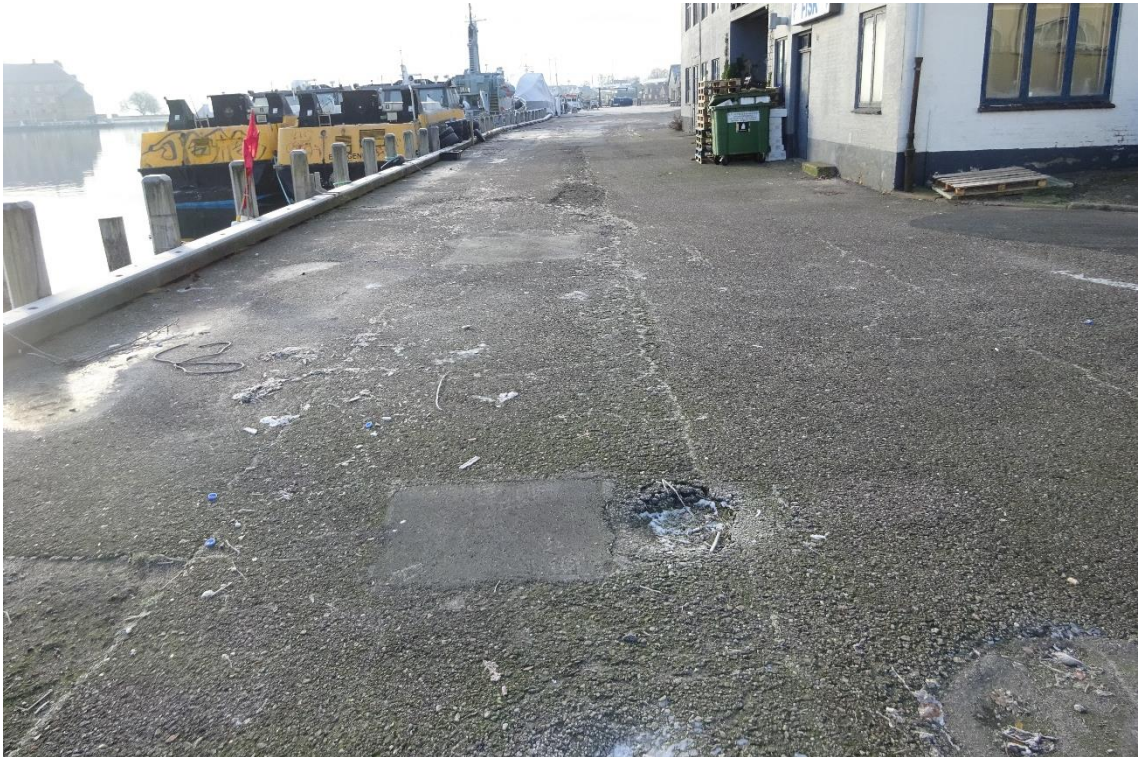
Figur 16: Huller og slidt asfaltbelægning ved strækning 3. Slidtage, frost/tø
