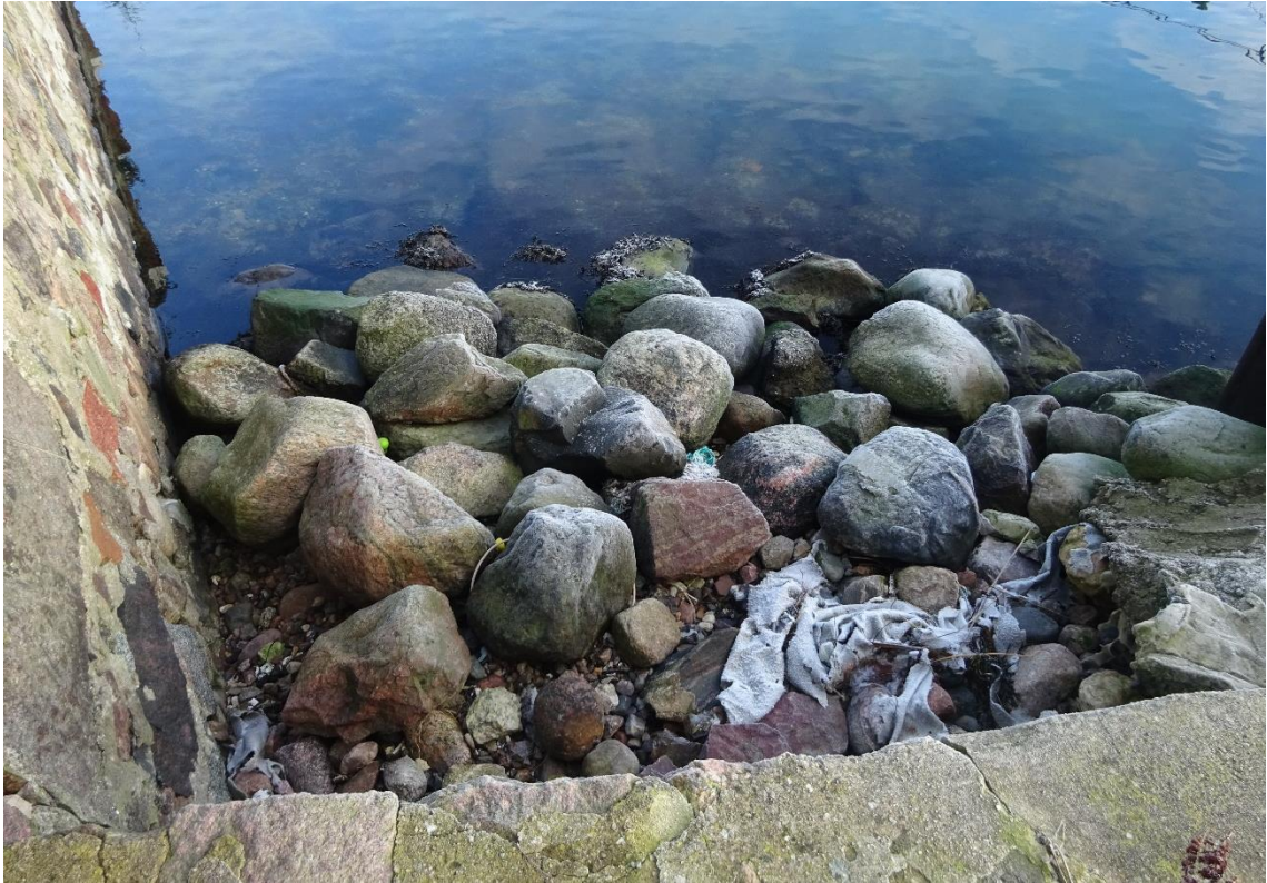
Figur 17: Stenskråning slidt med synlig fiberdug ved strækning 3. Vind og vejr
