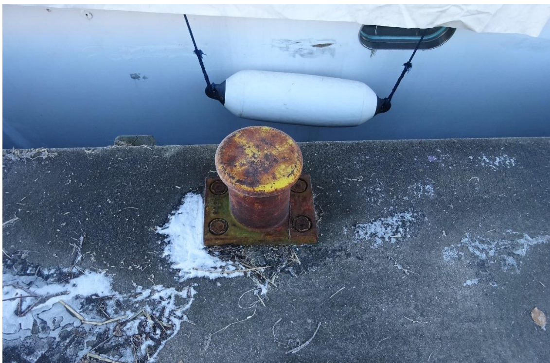
Figur 14: Malingsbeskyttelse er væk. Ses kun overfladisk korrosions. Slidtage
