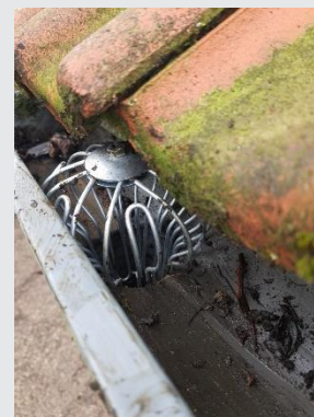
Rottesikring af tagedløb
