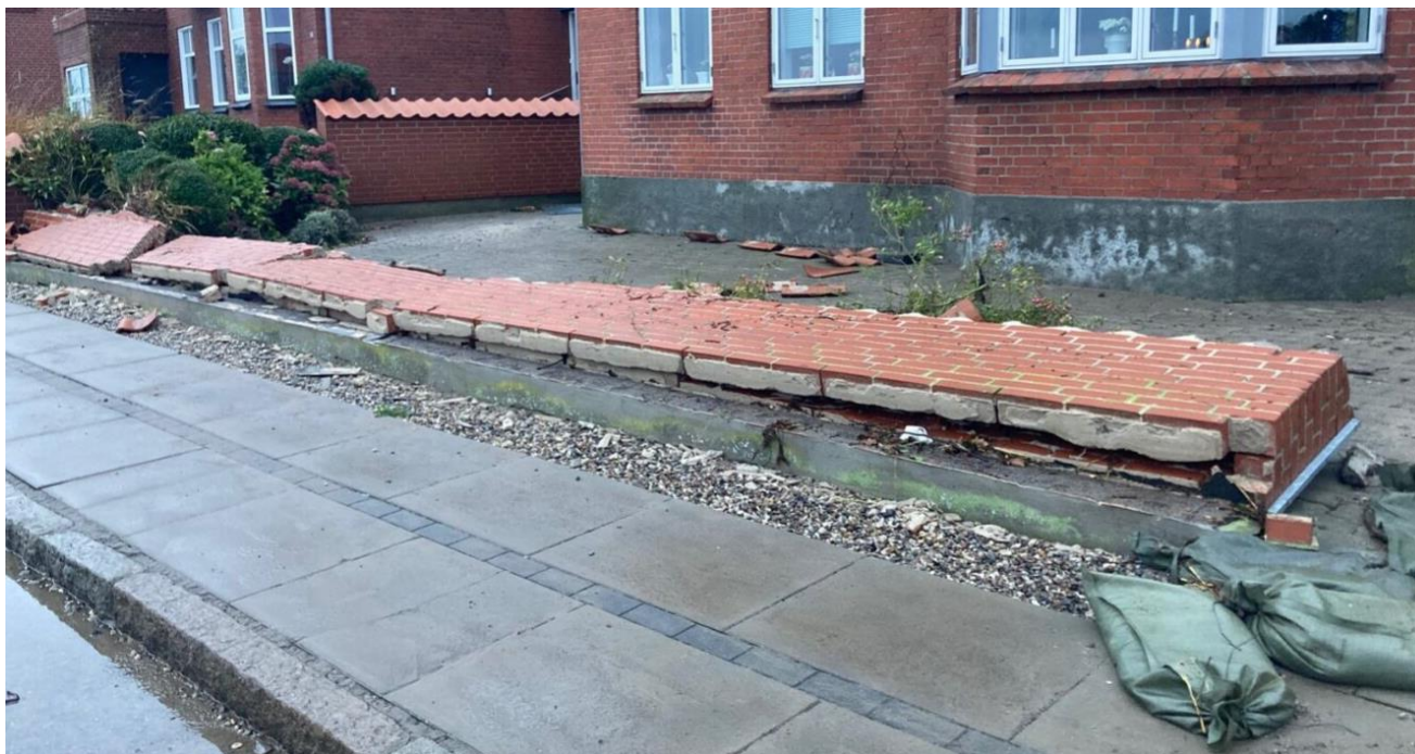
Figur 4.11: En ødelagt mur under stormfloden, dagen derpå i Sundgade den 21. oktober 2023 om morgenen.
